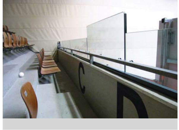
Immagine 35 Dispositivo anticaduta di vetro stratificato rialzato nella zona della scala
